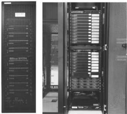
图4 本质安全DCS隔离站组实物
